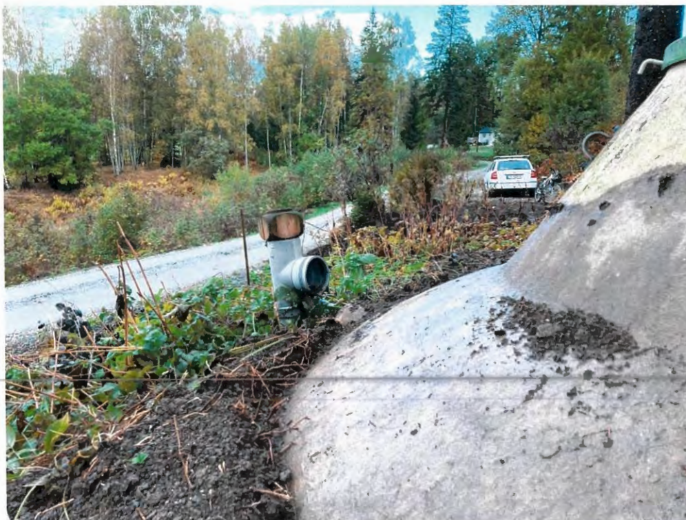
Bilde viser tanken med avløpsstuss. Tanken har ikke vært tømt, men svartvann renner ut kontinuerlig.
