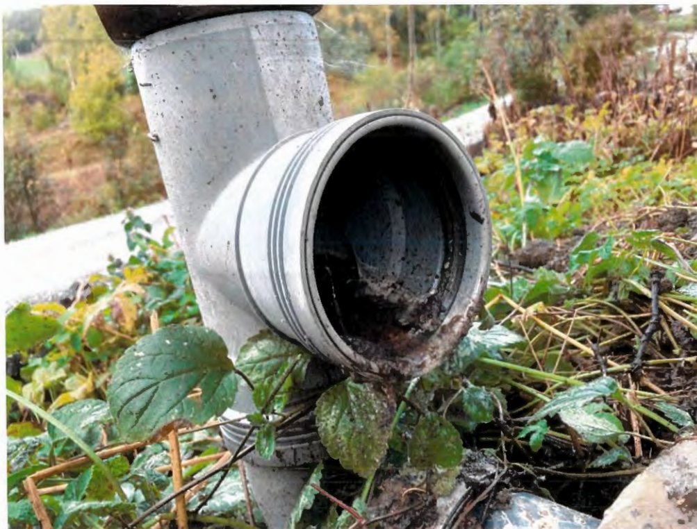
Bilde viser stussen hvor det kontinuerlig slippes ut svartvann i dagen.
